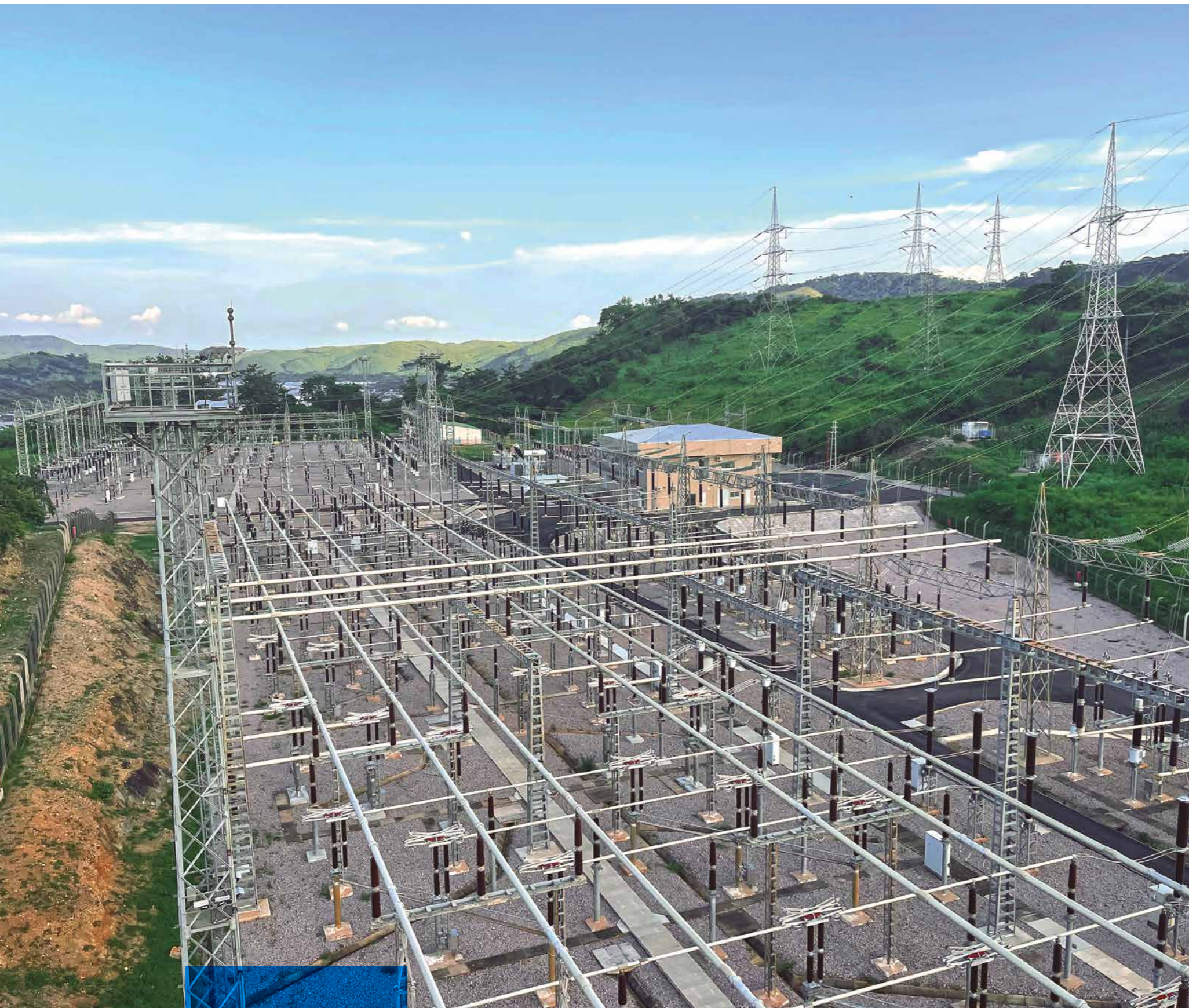
Subestación Inga (Rep. Dem. Congo)
