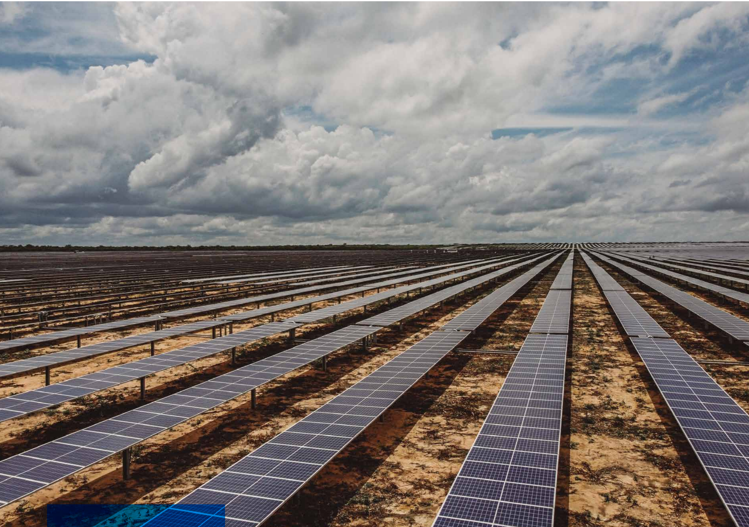
Planta solar fotovoltaica São João de Piauí (Brasil). Celeo
