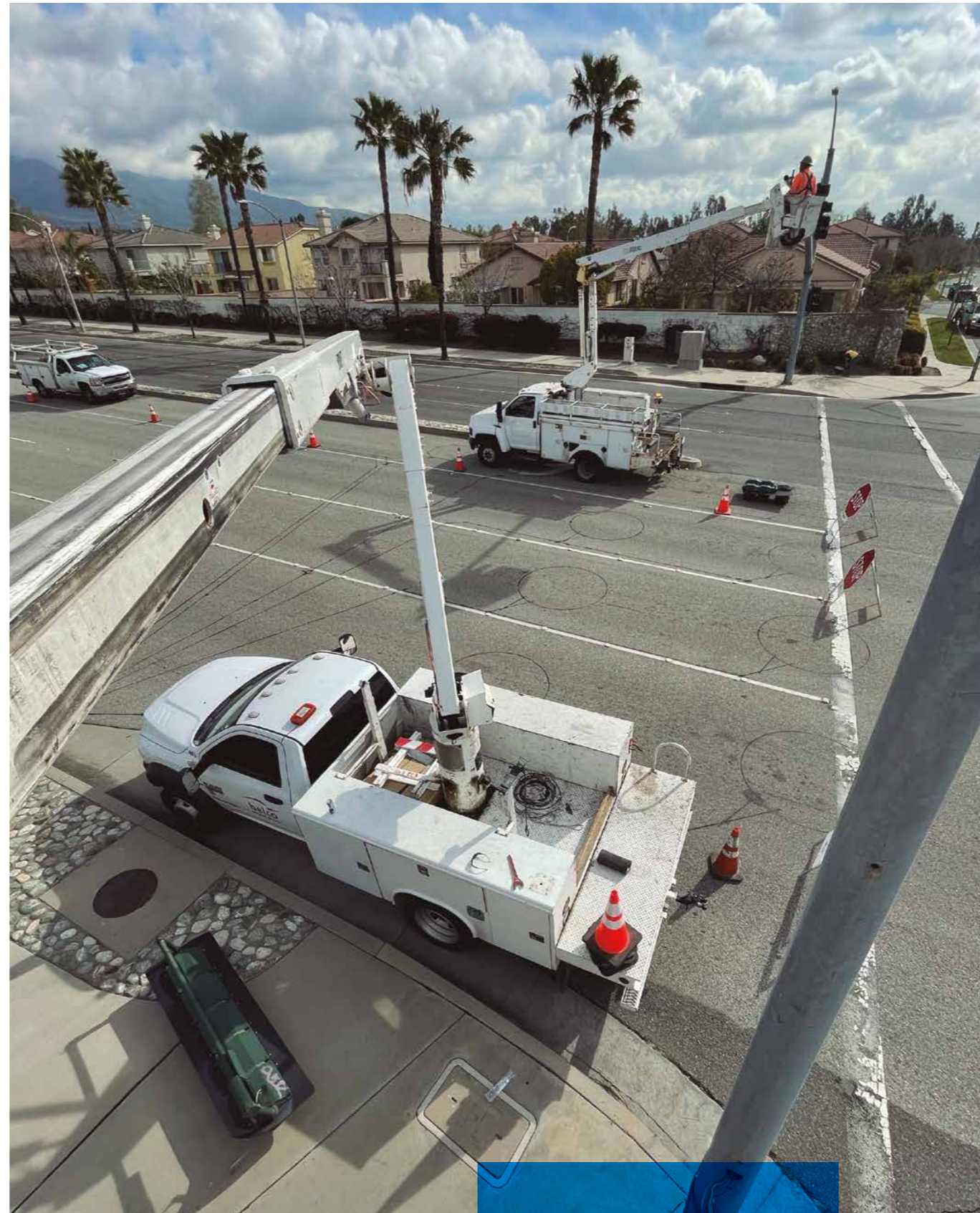
Iluminación viaria (Estados Unidos). ELEC NOR Belco
