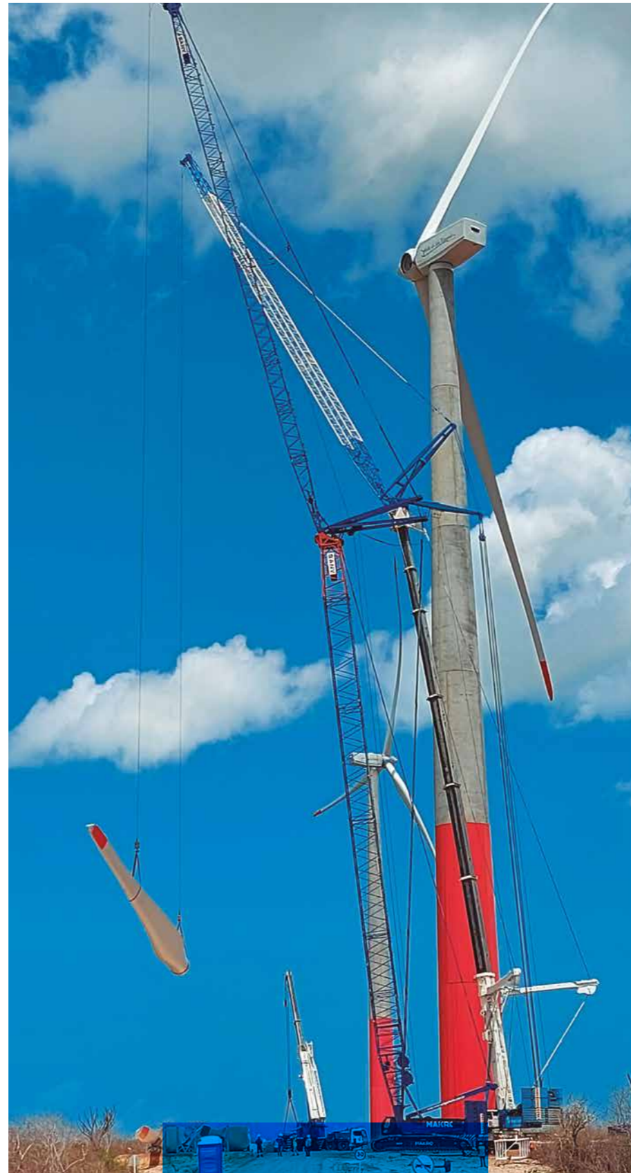
Parque eólico São Fernando I (México). Enerfin
