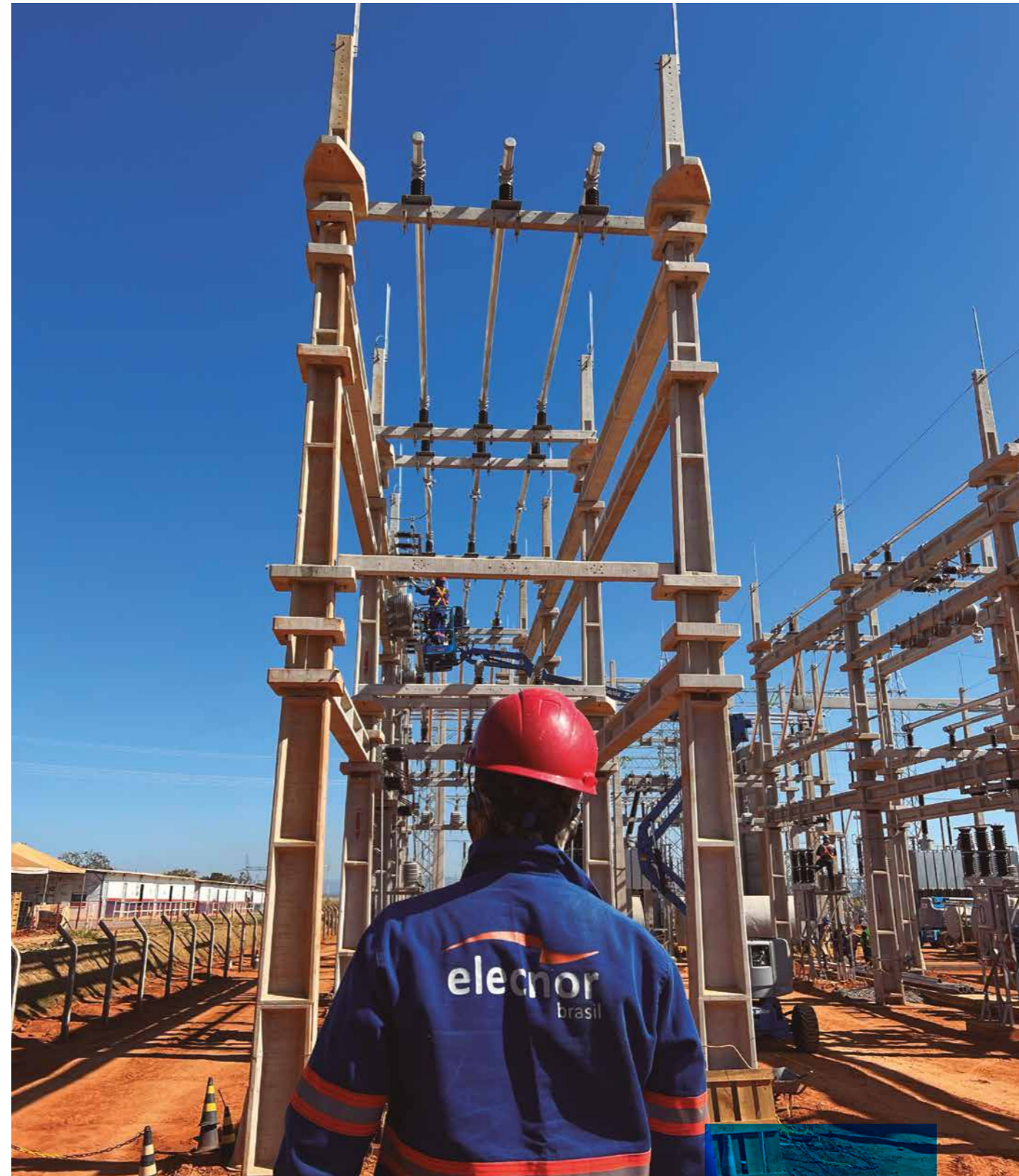
Subestación Pirapora (Brasil)
