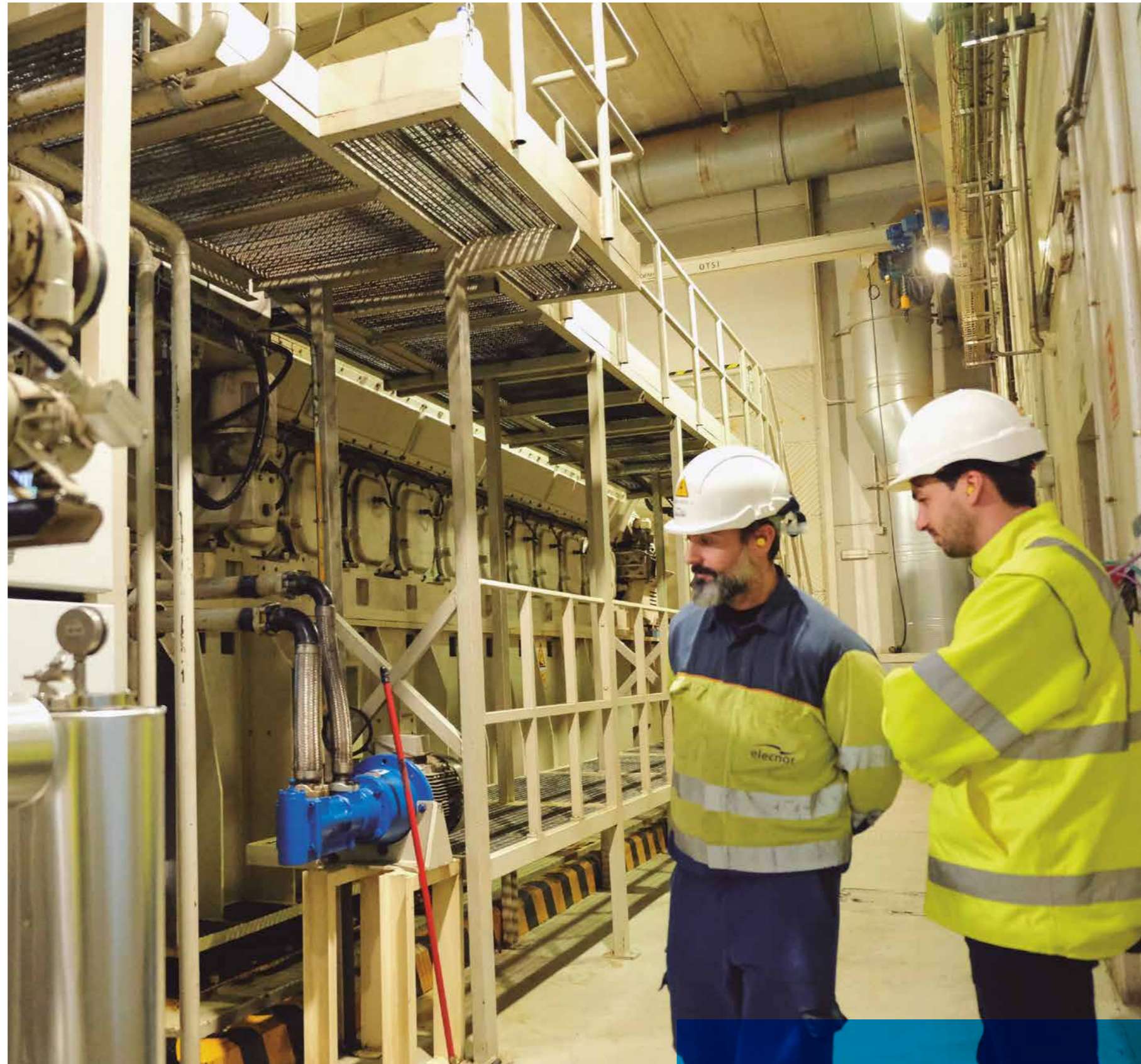
Operación y mantenimiento en Daimiel para Naturgy en Ciudad Real (España)
