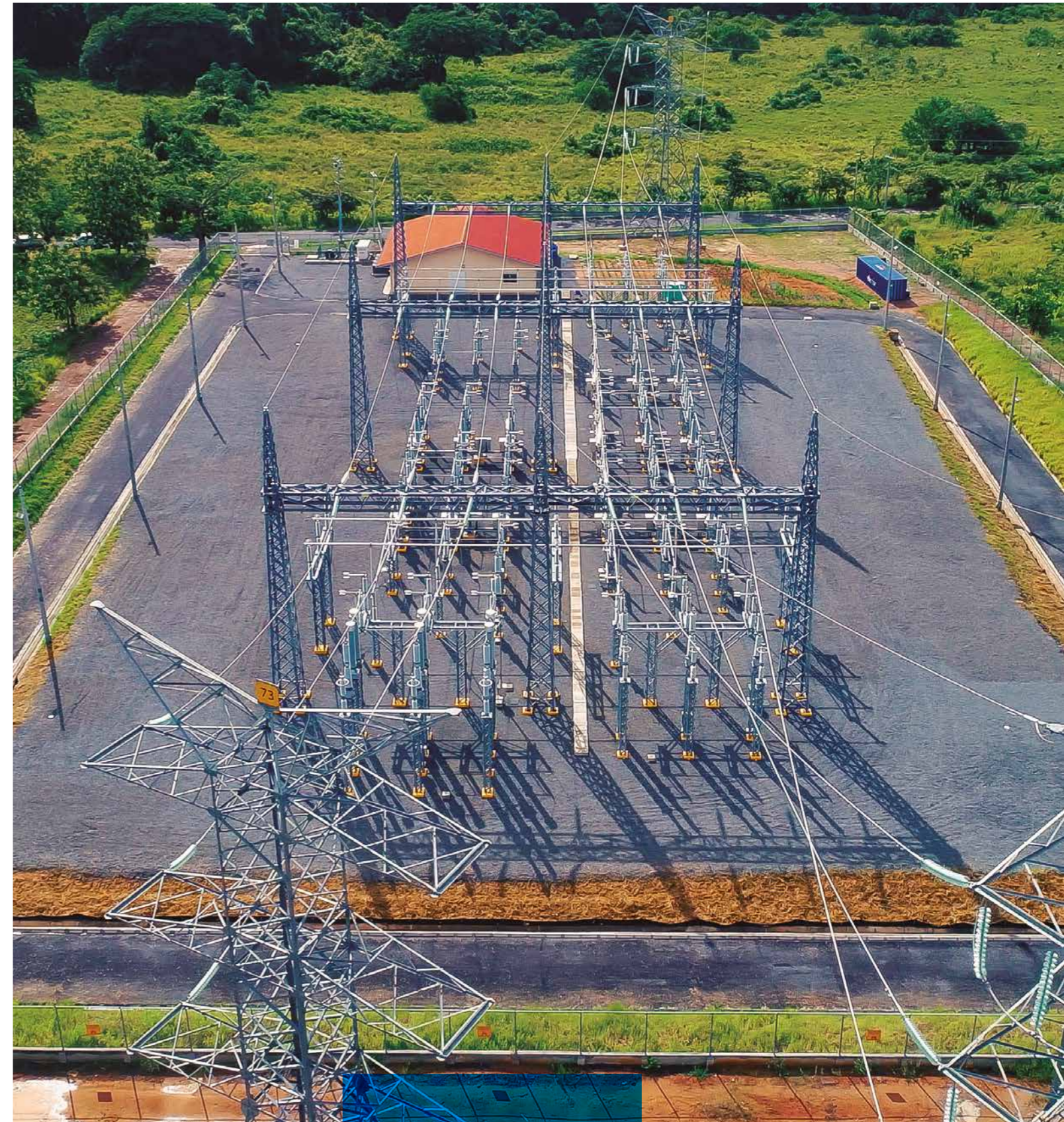
Subestación parque eólico Toabré (Panamá)
