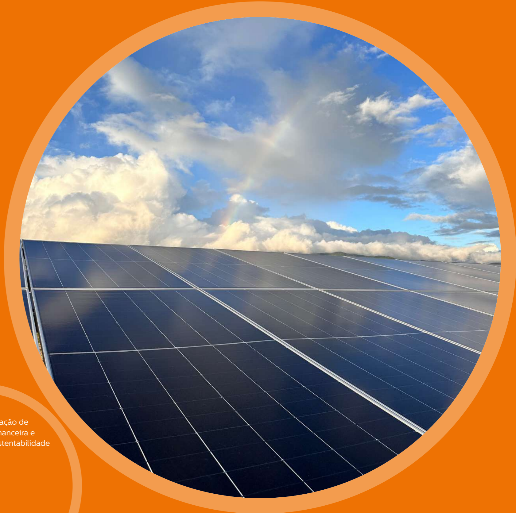
Parque solar fotovoltaico Esperanza II (Rep. Dominicana)
