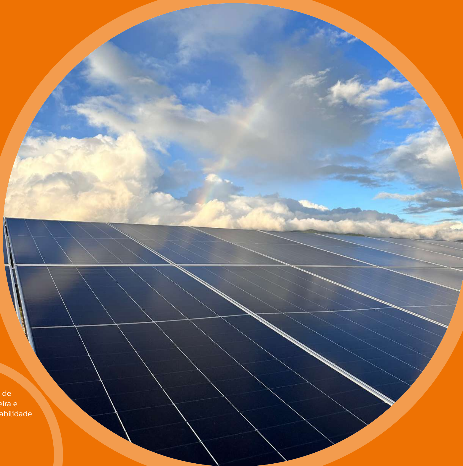
Parque solar fotovoltaico Esperanza II (Rep. Dominicana)
