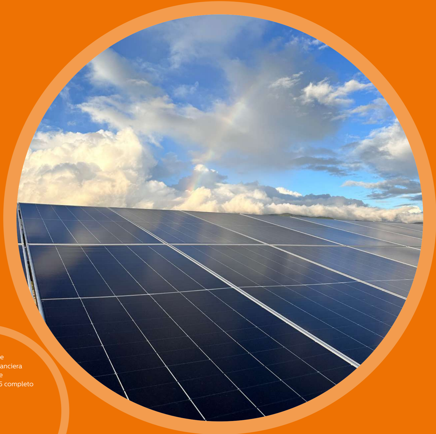
Parque solar fotovoltaico Esperanza II (Rep. Dominicana)
