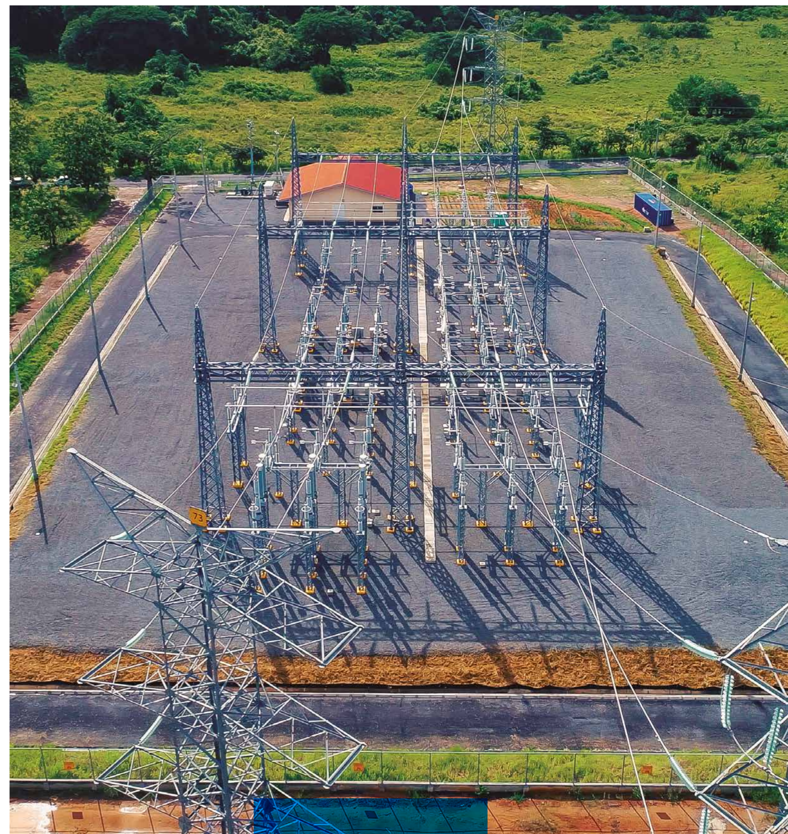
Subestação parque eólico de Toabré (Panamá)
