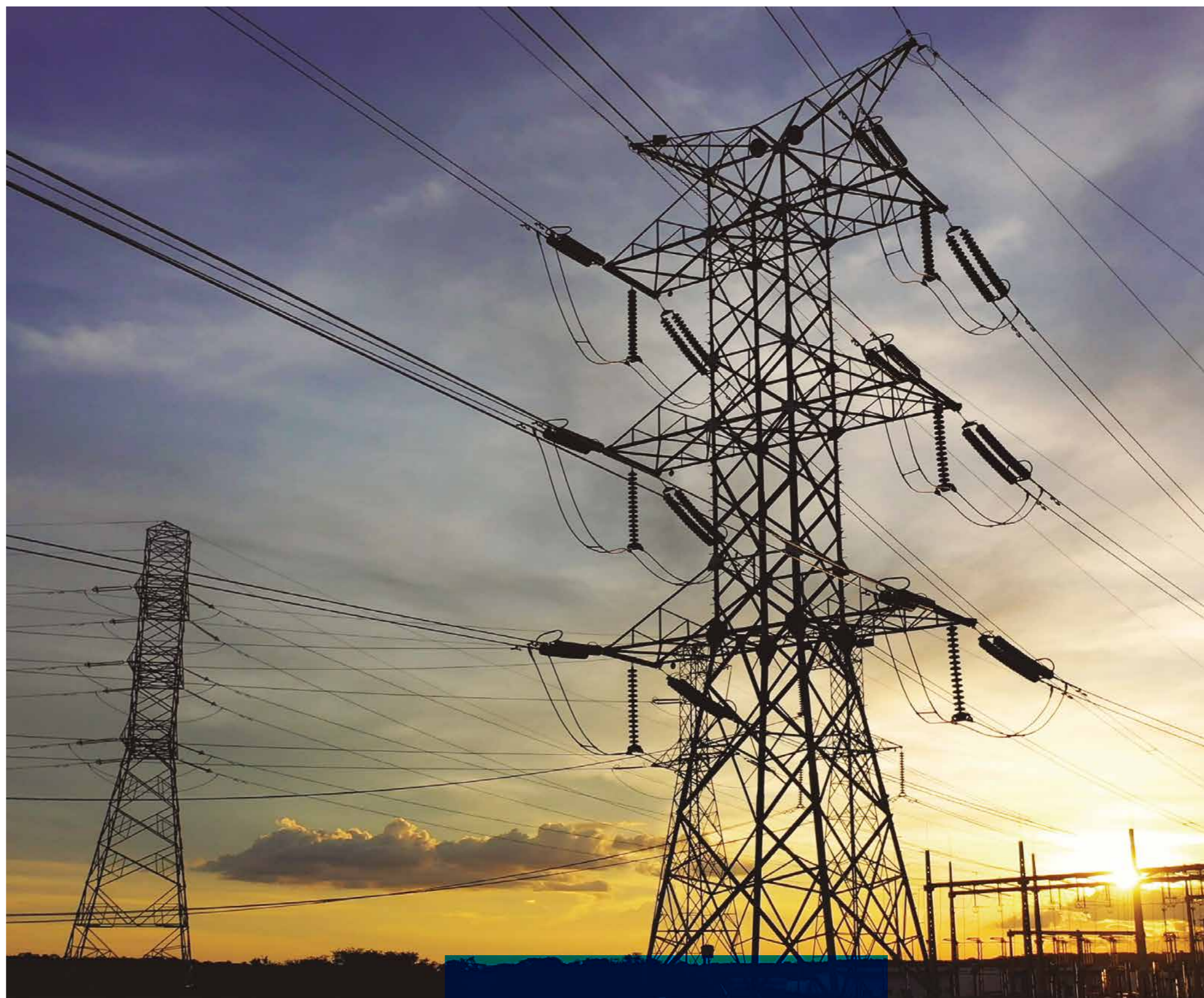
Projeto de transmissão Serra Ibiapaba Transmissora de Energia SITE (Brasil)
