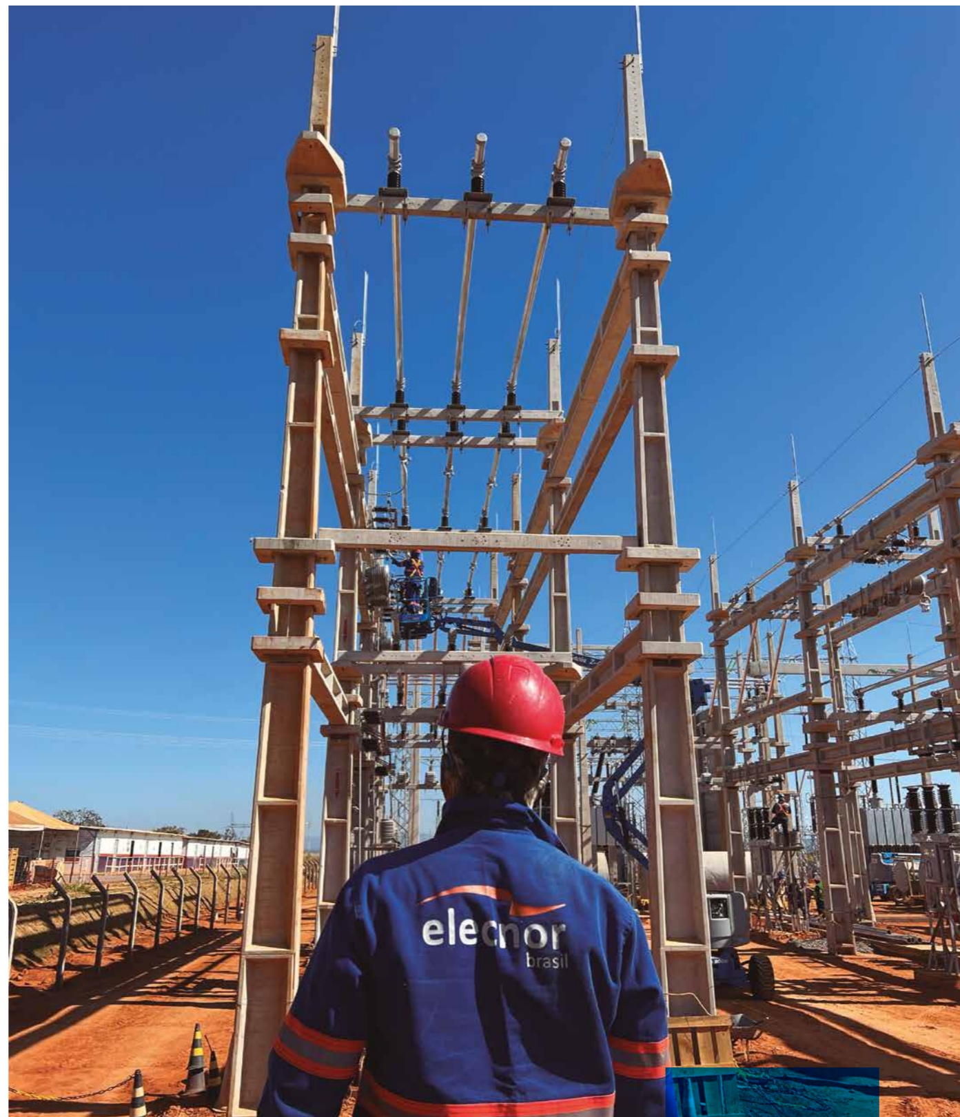
Subestação Pirapora (Brasil)
