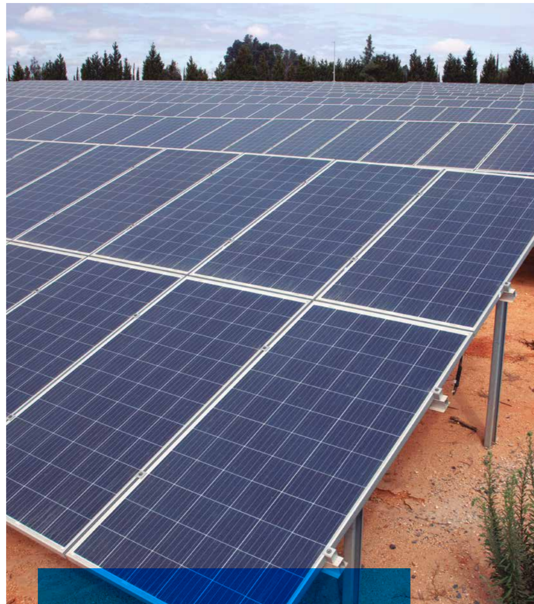
Parque solar para unidade de irrigação de Malpartida de Cáceres (Espanha)
