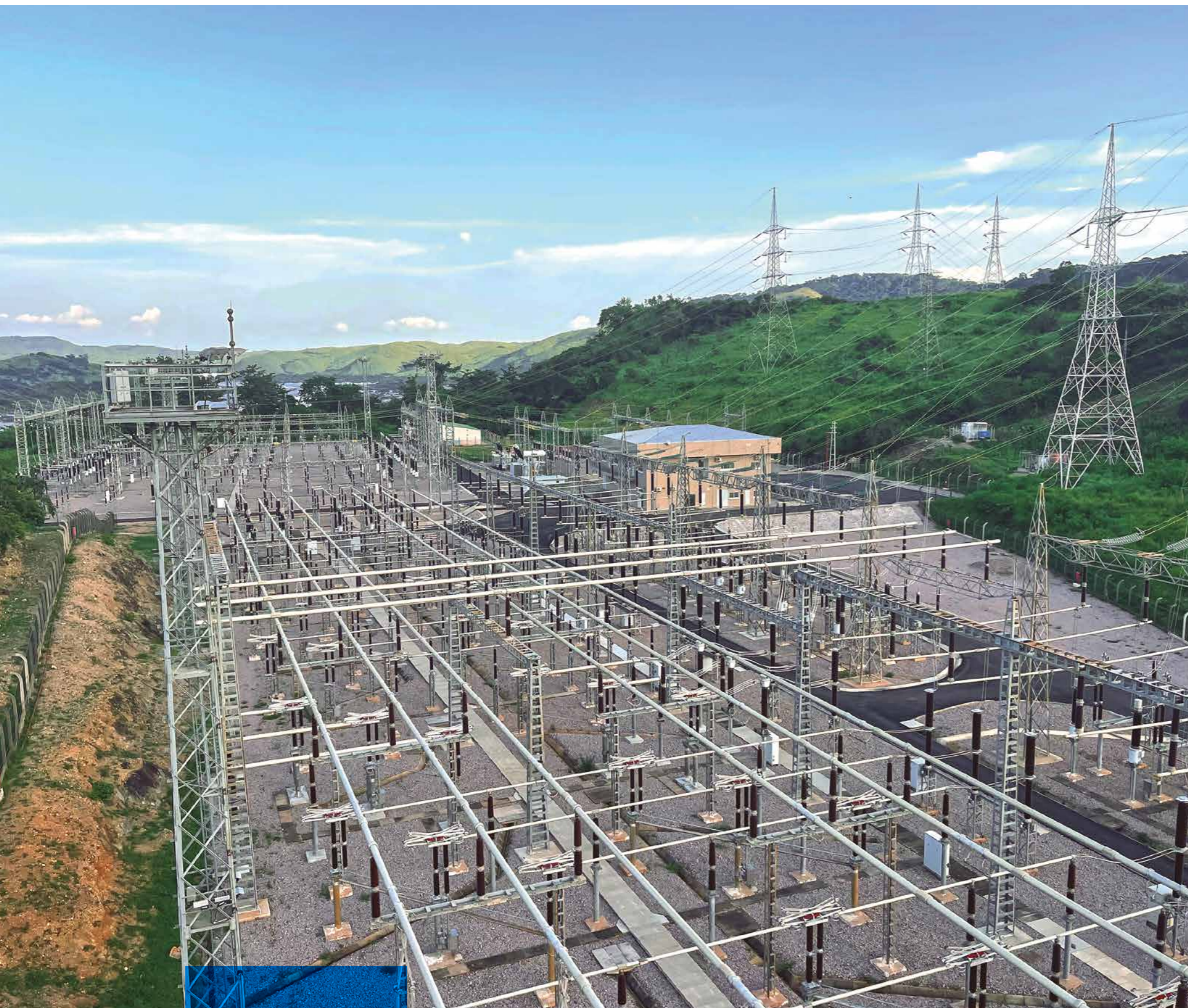
Subestação Inga (Rep. Dem. Congo)
