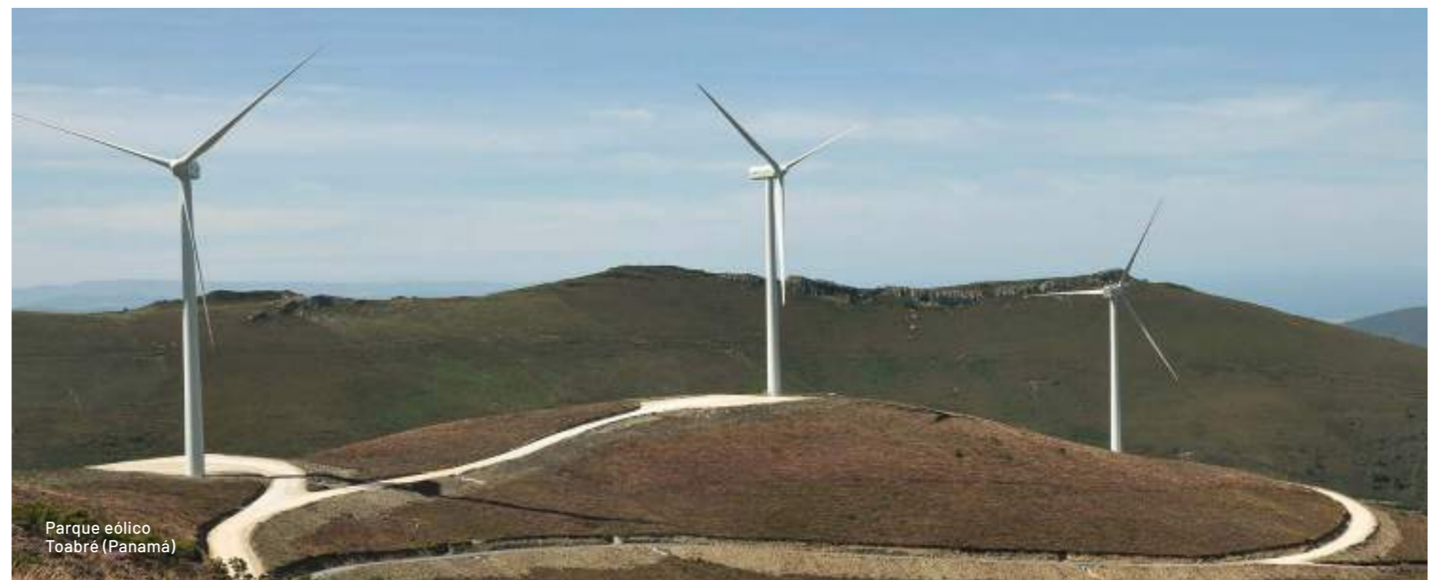
Parque eólico Coromuel en Baja California Sur (México)
